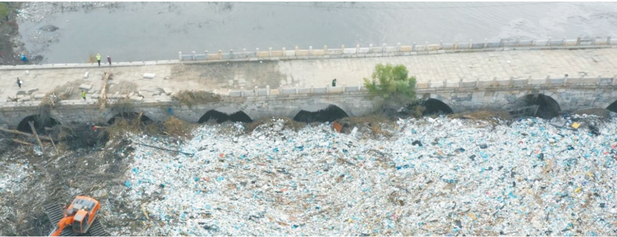
图1 琉璃河大桥受灾情况
